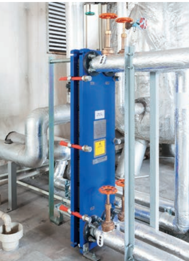
熱交換器で安定した給湯を可能にし、操作も簡単なことから作業の効率化が図れている。
