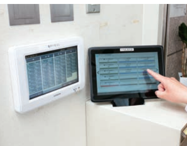
空調設備運用と電力使用状況を一括監視し効率化を支援。タブレット端末による省スペース化、スムーズな操作性を実現している。
