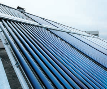
屋上に設置された太陽集熱パネル。自然エネルギーを利用し、省エネ・省コストを実現。
