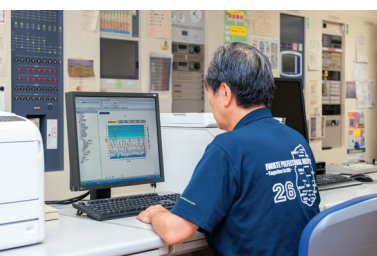
地下1階にある中央監視室で、病院内の空調・照明の一括管理。
