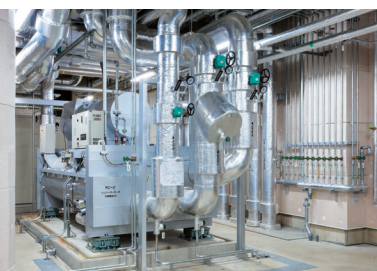
地下1階の機械室には、環境性・経済性・災害時対応を考慮した高効率インバーターターボ冷凍機を採用。冷房・暖房の負荷の低減にも貢献している。
